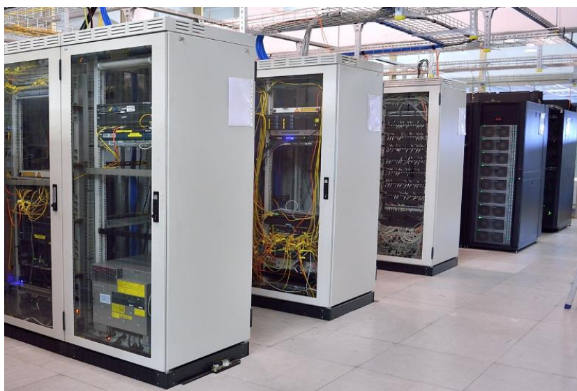
Ormari za poslužitelje i komunikacijsku opremu u podatkovnom centru DC Srce1
